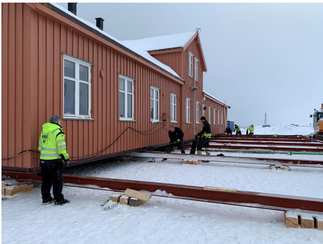
Refundamentering av Italia. Alt må klaffe når bygget, med håndkraft, skal flyttes, opp og vekk fra fundamentet, for å gjøre plass for borerigg og nye pæler. Mars. Foto Aud J Nergård.
