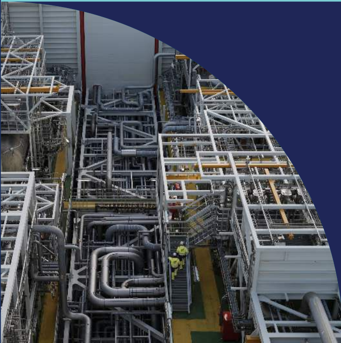
Johan Castруп produksjonsanlegg. Foto: Equinor
